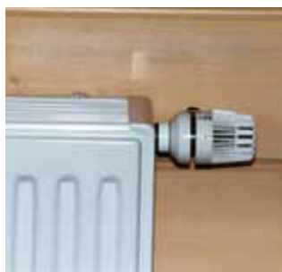
Radiator met thermostatische kraan.
