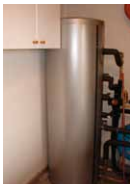
Opslagvat van de zonneboiler.
