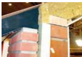
Geen koudebrug via continu doorlopende isolatielijijn.
